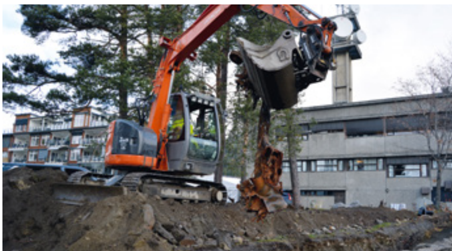
Hele familien er i arbeid. Tors bror Jo Oxhovd har investert i egen gravemaskin. Her graver han ned fjernvarmerør, og opp kommer restene av ei gammel folkevogn Boble som plutselig kom til syne etter en del strevsomme år under torva. Foto: Avis Valdres/Anne Kjønniksen
