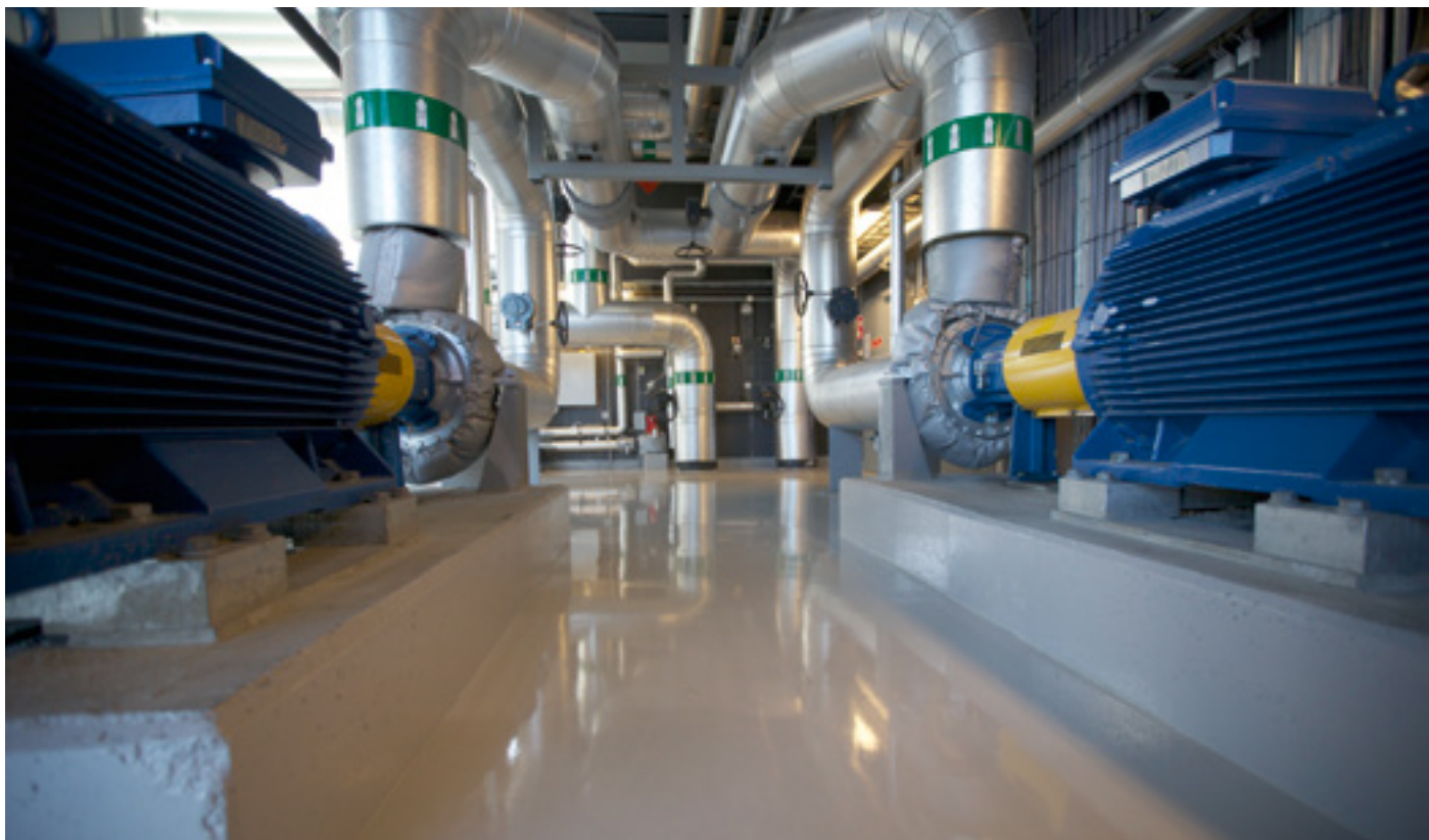
Hjertet i varmesentralen er verdens største ammoniakkbaserte varmepumpe som kan levere 13 MW varme ut på fjernvarmenettet med en temperatur på 90°C.
