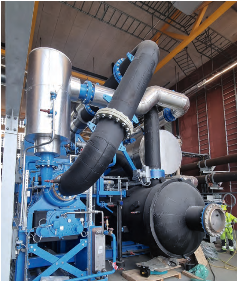
Den svarte fordamperen venter på å heve varmen ved hjelp av gass, som skal videre til kompressoren gjennom den svarte sugeledningen. Foto: Nikolai H Moskvil
