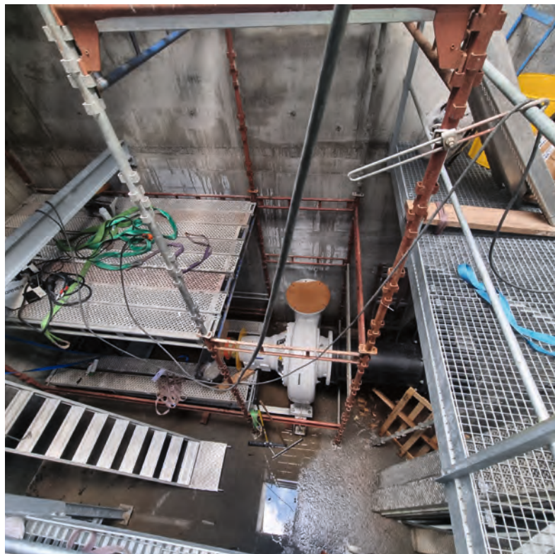
En vannledning med selvfall tar sjøvannet til en kum med sirkulasjonspumpe. Derfra sendes det videre til en av varmpumpene.
