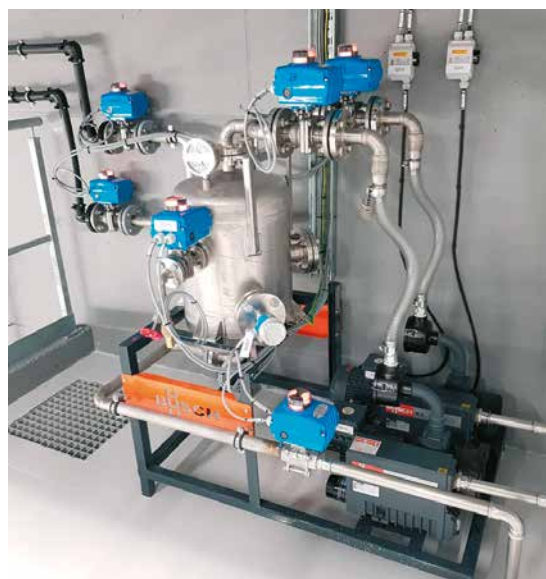
Vakuumanlegg for kontroll av vannstrømmen i inntaksledningen. Systemet består av aktuerte ventiler, vakuutank, vakuumpumper og instrumentering. (Foto: Lyse Neo)
