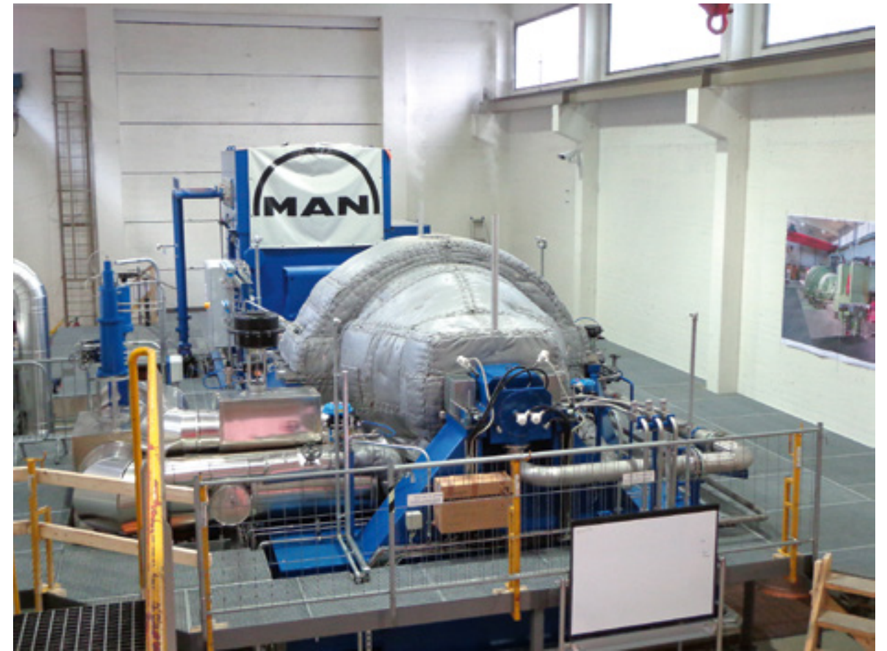
Som første smelteverk i Norge installerte Bjølvefossen allerede i 1978 en dampkjel og dampturbin for å utnytte de varme avgassene fra ovnene til strømproduksjon. Norsk Energi hadde i 2015 ansvaret for installasjon av en ny dampturbin og omkringliggende utstyr. Den nye turbinen øker Bjølvefossens energigjenvinning fra 50 til 80 GWh/år.
