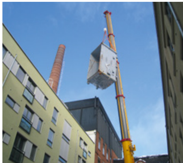
Her heisen kjelen på plass i Rodeløkka Varmesentral som ligger i tidligere Freia fabrikk i Oslo.
