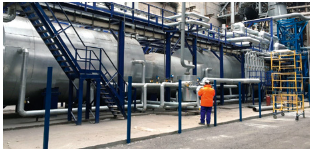
Varmegjenvinningsanlegget i Chelyabinsk. De varme avgassene går først gjennom rørveksler for overheting av dampen, og deretter gjennom to fordampere.
