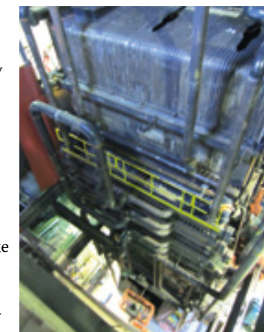
Elkem Chicoutimi valgte en vannrørkjeler for å gjenvinne varme fra ovngassene. Dette åpner muligheten for installasjon av en dampturbin for strømproduksjon på et senere tidspunkt dersom dette blir aktuelt.
