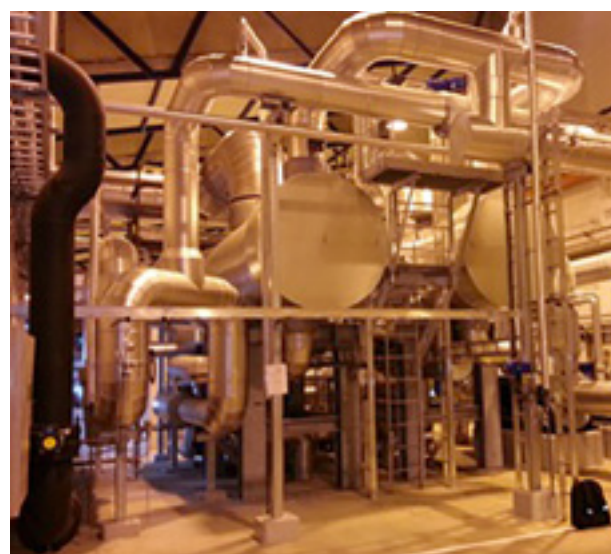
Spillvarme fra Yara på Herøya er utnyttet til fjernvarme i Porsgrunn.
