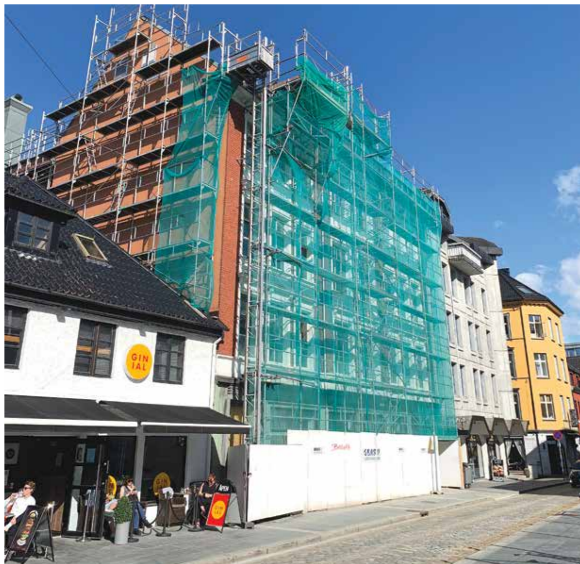
Oppgraderingen av Bergen Kulturhus viser at det også i gamle bygg er mulig å få til energiltak som gir vesentlig reduksjon i energiforbruket. Foto: Kristin Nørstebø, Norsk Energi.
