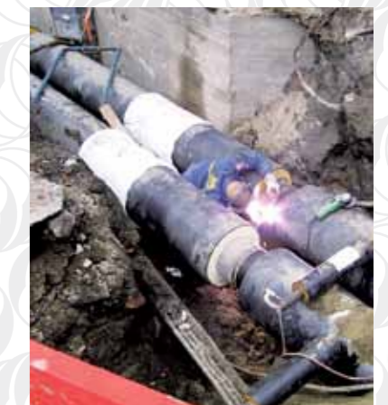
Drammen Fjernvarme har investert store beløp i utbyggingen av fjernvarmenettet de siste årene.
