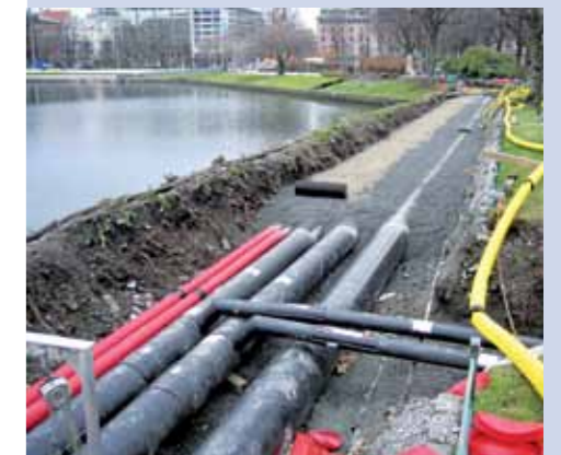
BKK skal fortsette utbyggingen av fjernvarmenettet de nærmeste årene.
