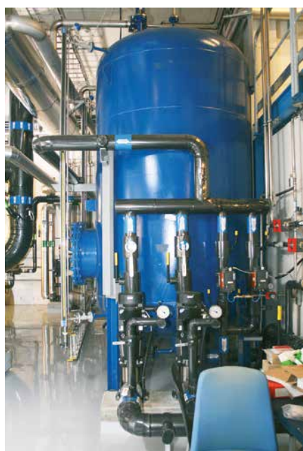
Skreddersydd trykkløst/ekspansjonsanlegg med nitrogen atmosfære over vannspeilet.
