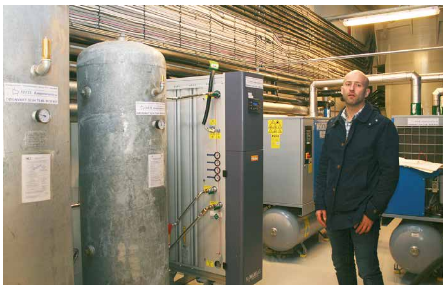
I forgrunnen sees nitrogentanker og nitrogengenerator. I bakgrunnen kan man se 2 luftkompressorer. Nitrogen benyttes for å hindre O2 inntrengning og korrosjon i ekspansjonstankene.
