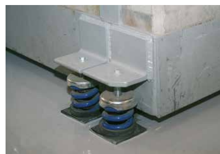
Fjærer brukt for å vibrasjonsisolere teknisk utstyr i sentralen fra bygget.
