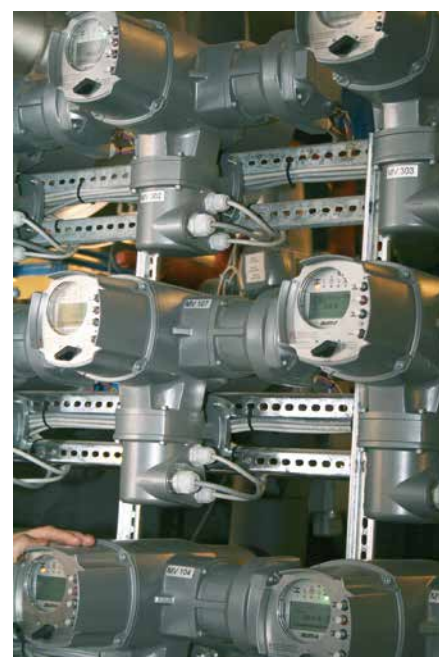
Controllenbeter for ventilmotorer er samlet på betjeningsvennlig sted.
