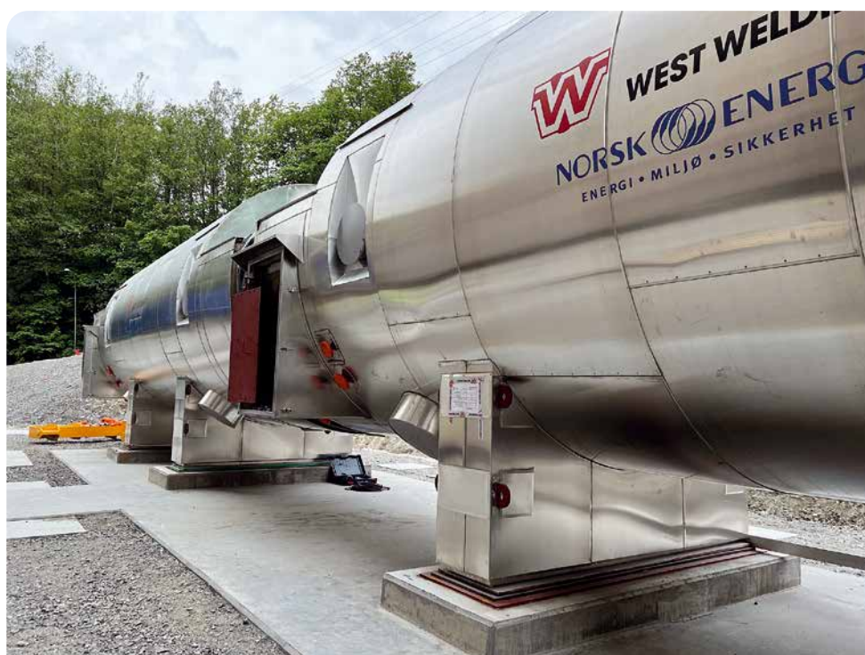
I mai 2022 kom de første røykrørkjelene til Norcem og markerte med det startskuddet for installasjon av fangstanlegget. Alle ni røykrørkjelene som skal varmegjenvinne avgass fra sementanlegget ble installert i løpet av 2022.
