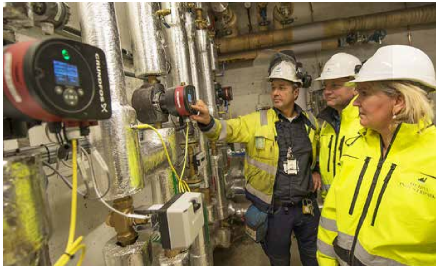
MILEPÅL: De har all grunn til å smile; Første bygg i industriparken er koblet til fjernvarmenettet. Fra venstre Skjalg Aasland og Tove A. Kilen, Herøya Industripark AS, og Pål Berg, Bilfinger. (Foto: Ole Bjørn Ulsnæs)
