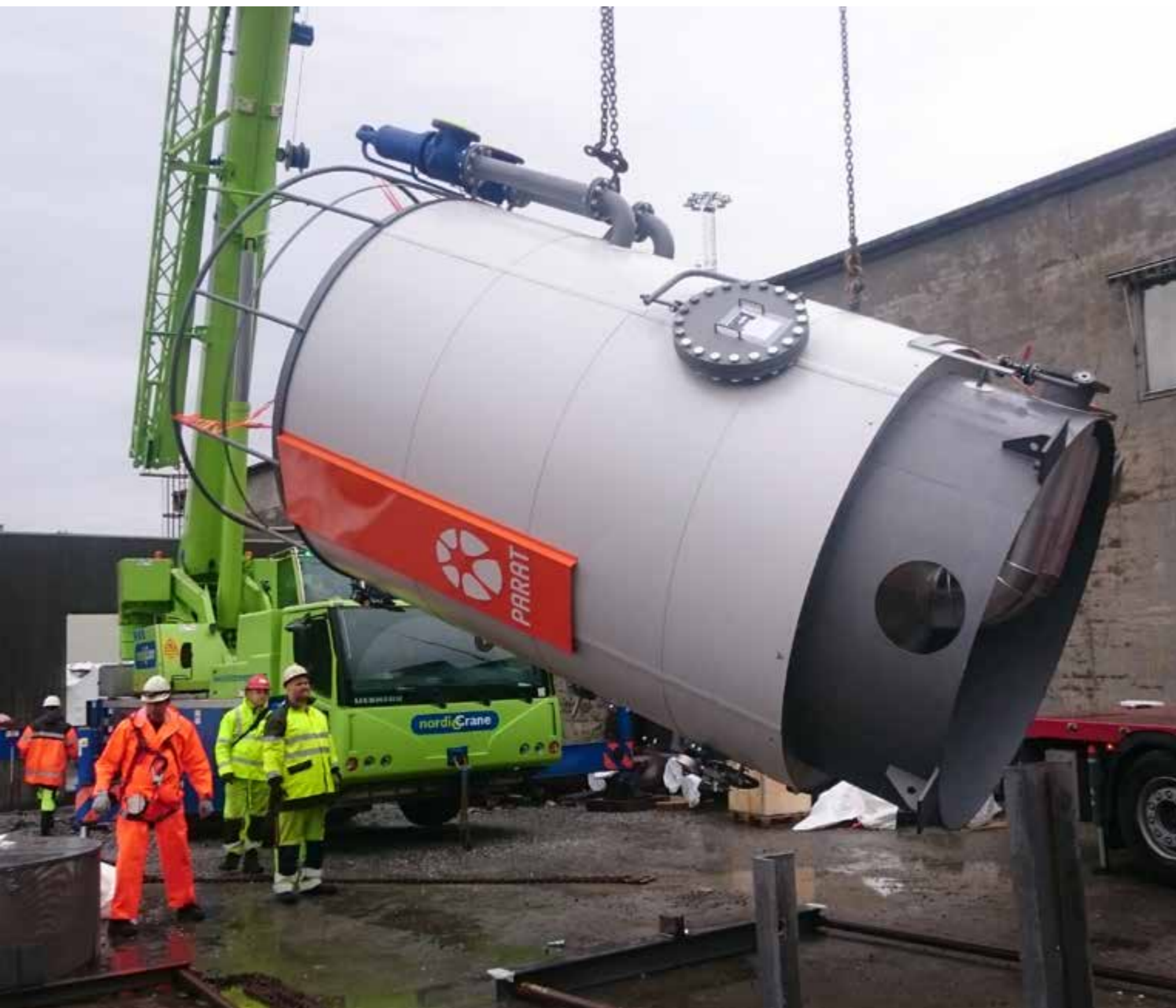
Elektrokjelen ble heist på plass i august 2015.
