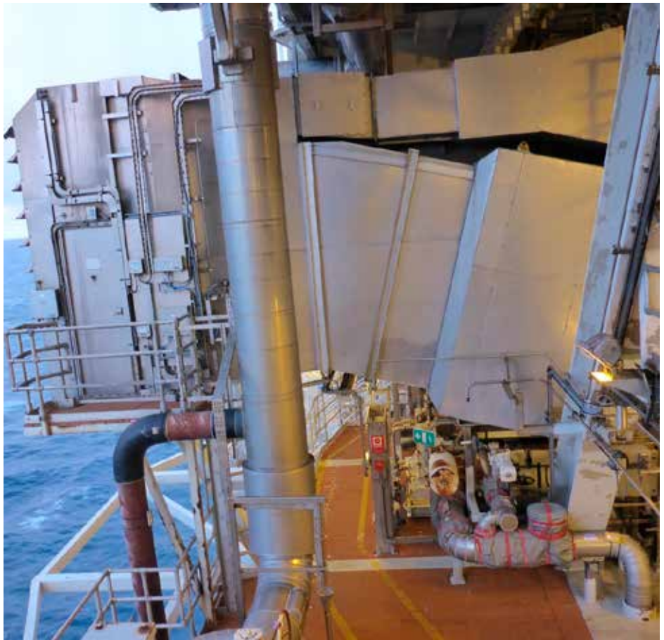
Over: Luftinntaket til gassturbinen på Grane-plattformen.
