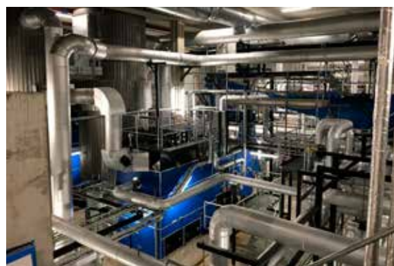
Kjelhallen hos Oslofjord Convention Center. Areal varmesentral er 785 m 2 og silovolum er 690 m 3 .
