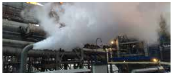
Det ferdige anlegget ble igangkjørt like før jul. Bildet viser renblåsing av en av rørdningene med damp. Foto: Jonas Mikkelsen, Vatvedt Technology AS.
