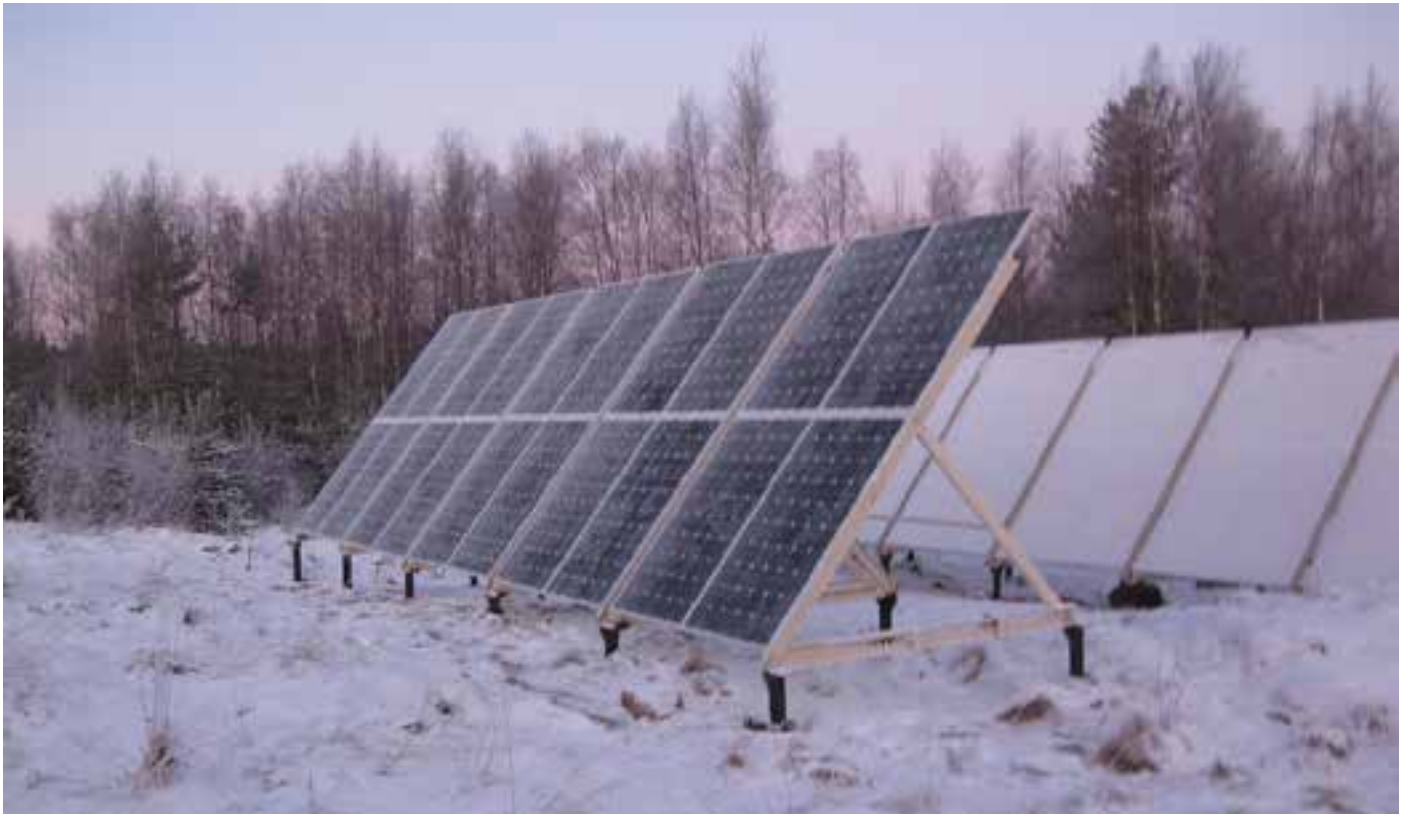
Sollcellene i landsbyen Kimovaara ble montert i januar 2016.
