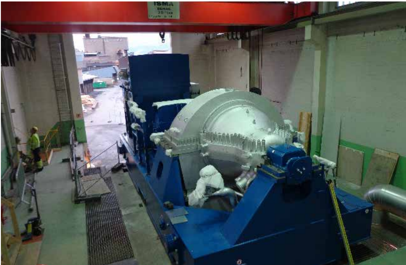
Ny turbin med generator er nå på plass, og energigjenvinningen fra ovnene vil nå øke fra 50 GWh til 80 GWh.
