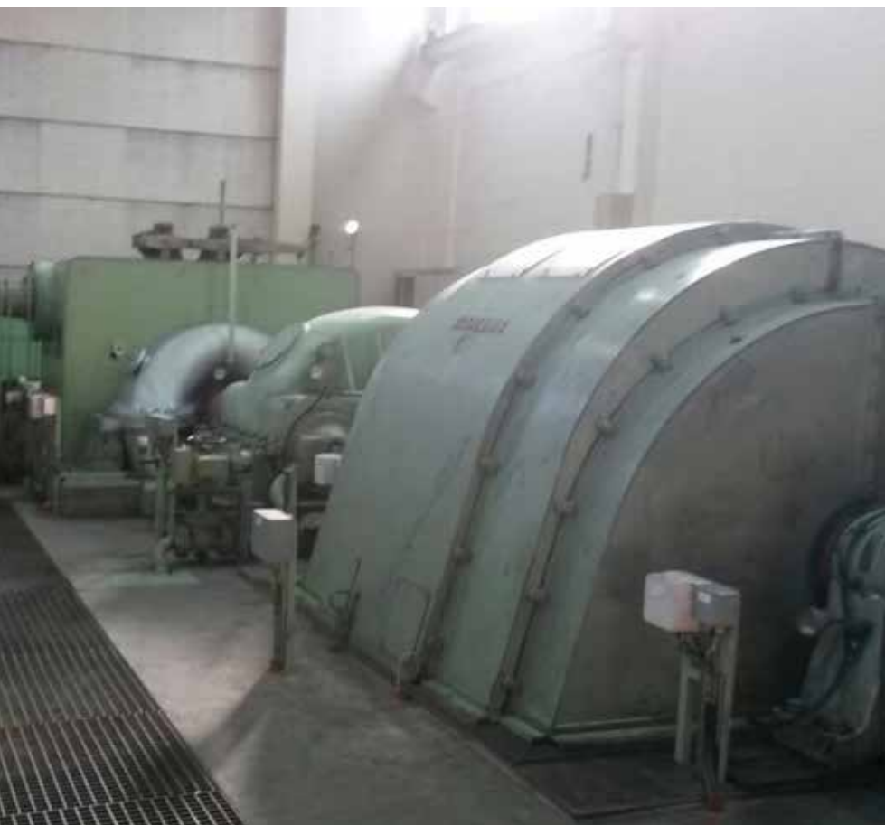
Den gamle turbinen ble overhaldt i 2008-2010, og da ble det funnet noen skader som gjorde at verket måtte vurdere å installere en ny turbin.
