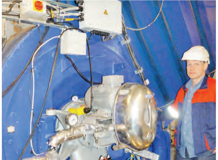
Kjelen i den nye varmesentralen på Rodeløkka er utstyrt med Saacke rotasjonsbrenner. Bildet viser Norsk Energis prosjektleder Hallstein Brandal ved brenneren.
