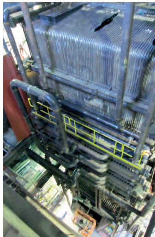
Varmegjenvinningsanlegget som Norsk Energi har prosjektert for Elkem i Canada skal utnytte avgassvarmen fra ferrosilisiumovnene til å produsere damp til nabobedriften Rio Tinto Alcan. Bildet viser kjelene under montering.
