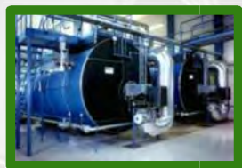
Olje- og gassfyrte kjeler fra 600 kW til 33 mW
