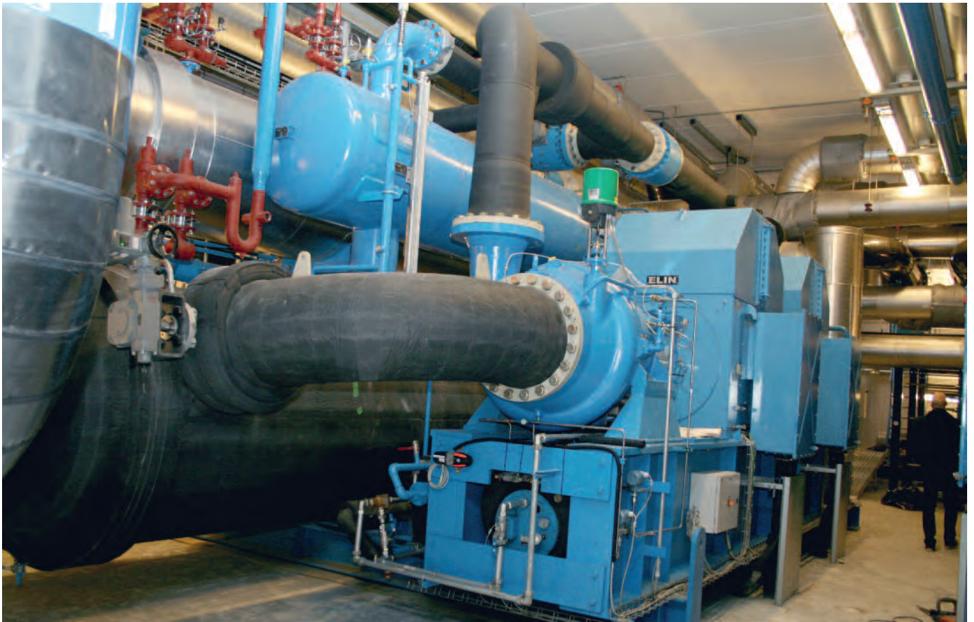
Varme- og kjølesentralen i Rolfsbukta på Fornebu har to varmepumper, hver med en ytelse på 8 MW varme og 10 MW kjøling. Varmepumpene er levert av det sveitsiske firmaet Fritherm.
