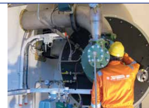
Glencore Nikkelverk, 7,6 Megawatt hauck lettoljebrenner, egedesignt brennkammer.
