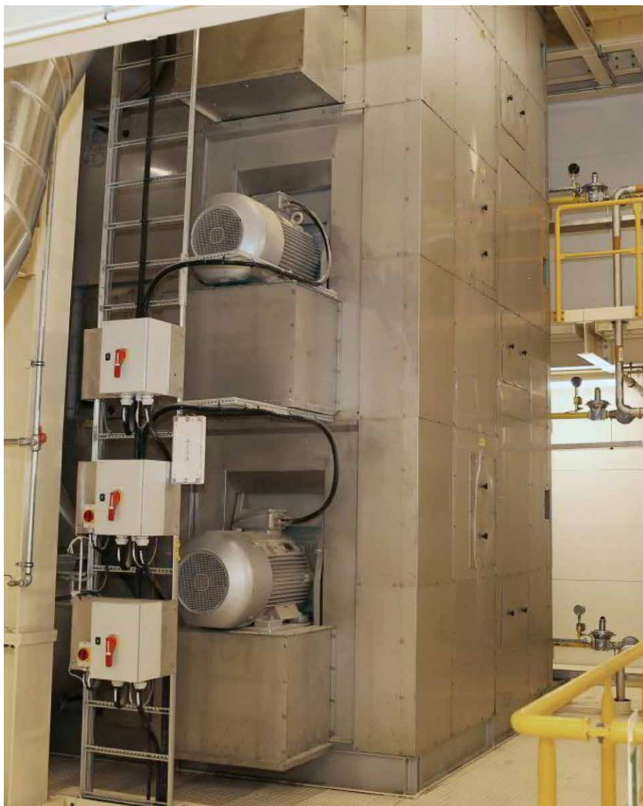
Den nye tørken er levert av Geelen Counterflow i Nederland. Norsk Energi var med å sikre investeringsstøtte slik at tørken kunne utstyres med høytemperatur varmepumper som varmekilde.
