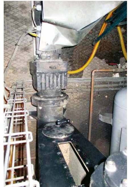
Stokerbeholder med rundt lokk nederst som blåste ut og skadet metalldeksel til venstre.
