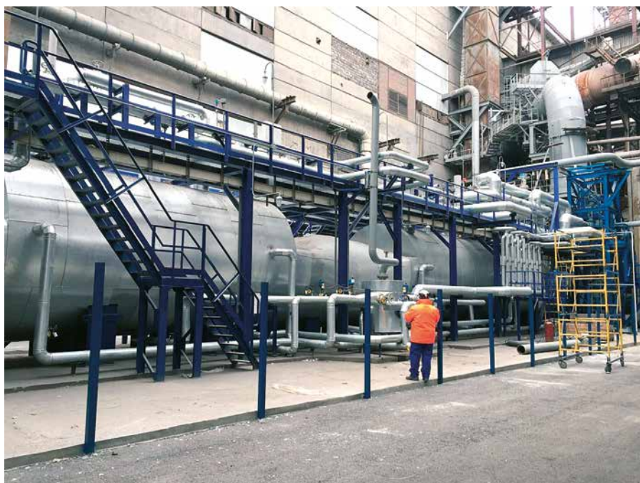
Varmegjenvinningsanlegget i Chelyabinsk. De varme avgassene går først gjennom en rørvexler for overheting av dampen, og deretter gjennom to fordampere.
