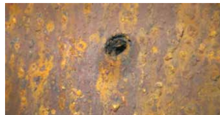
Eksempel på korrosjon og belegg i en nedblåsingstank.
