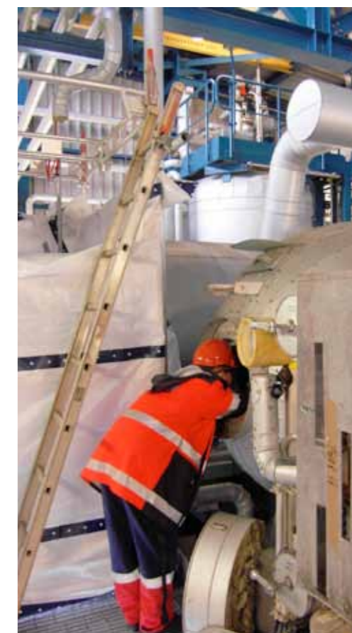
Gasskraftverket var stengt i flere uker mens tilstandskontrollen ble gjennomført. Konsulent Inge Schei ved Bergenskontoret i gang med kontrollen.
