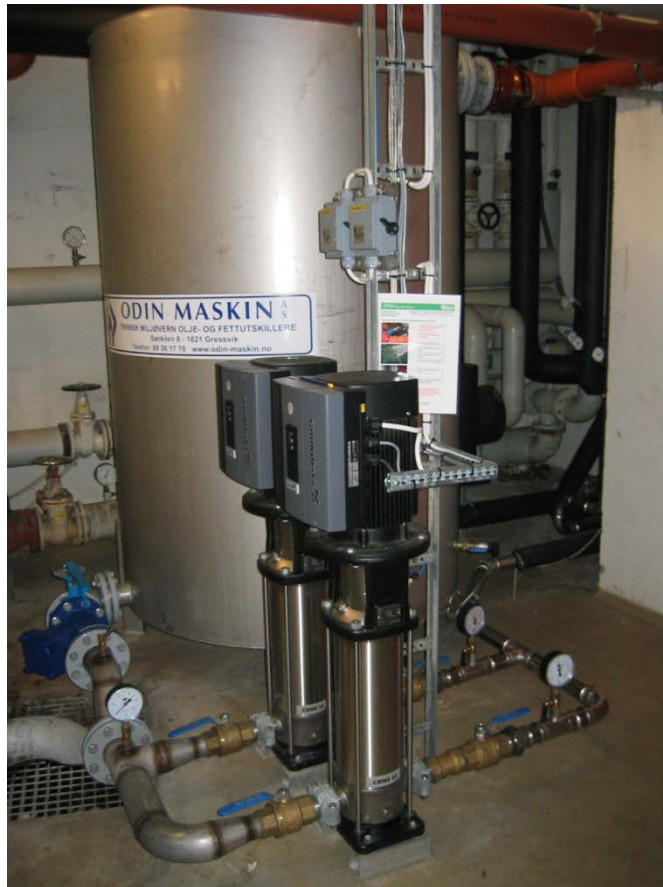
Lukking av vannkrets Maskinsal
